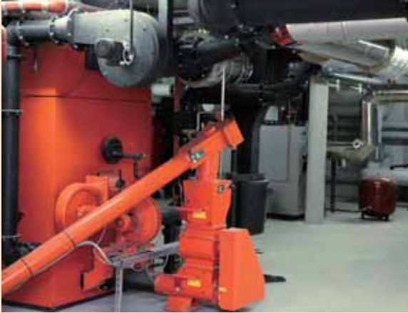
Die Dorfheizung Wildpoldsried mit Holzpellets.
